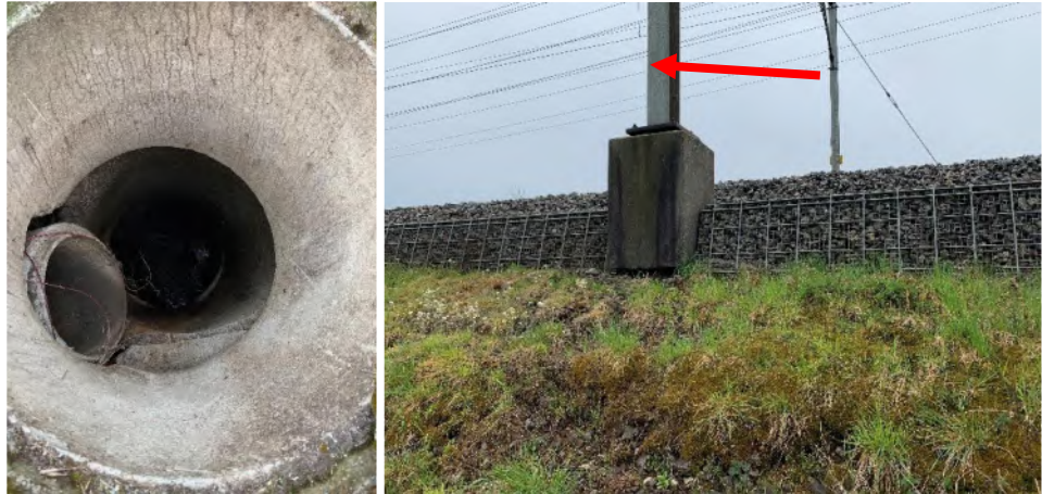
Abbildung 7 Senkungen im Bereich der Masten der Fahrleitung
